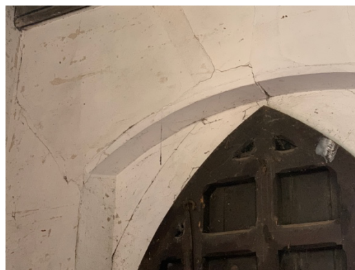
Plaster cracks over D2
